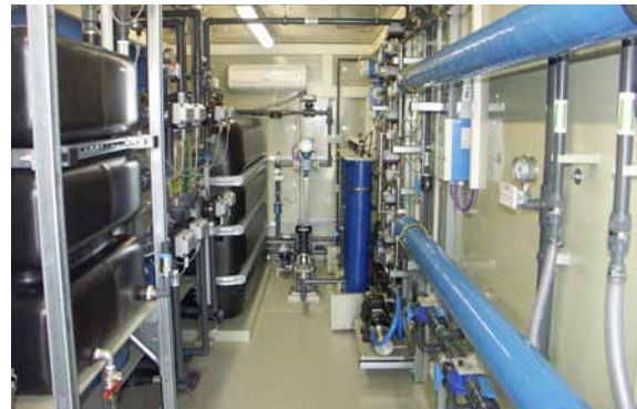
Abbildung 2: Die gesamte Technik wurde in einem Container untergebracht.
