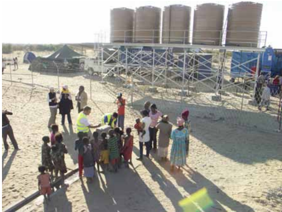
Abbildung 4: Die großen Wassertanks auf dem Dach dienen als Puffer, damit immer genügend Wasser zur Verfügung steht und die Osmoseanlage nicht trocken läuft.
