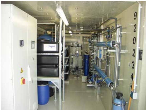
Abbildung 5: Links der Schaltschrank. In ihm wurde der eWON-Fernwartungsrouten von Wachendorff untergebracht. Dieser stellt die Verbindung zwischen der SPS, die die Anlage steuert, und dem BGAN-Satellitentransceiver her.
