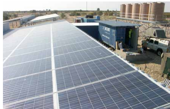
Abbildung 3: Die Anlage arbeitet ausschließlich mit Photovoltaik und ist damit völlig autark.
